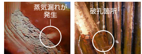
ボイラーチューブにおける破孔のイメージ
